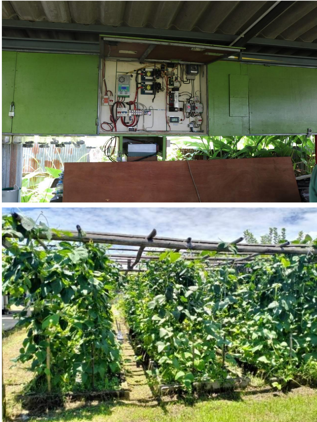
ภาพที่ 4 การสูบน้ำด้วยไฟฟ้า แบบตั้งเวลาอัตโนมัติ
